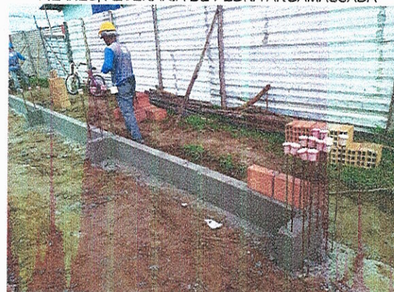
FERRAGEM DOS ARRANQUES DOS PILARES E CINTAMENTO INFERIOR; INÍCIO DA ALVENARIA DE BLOCO CERÂMICO
