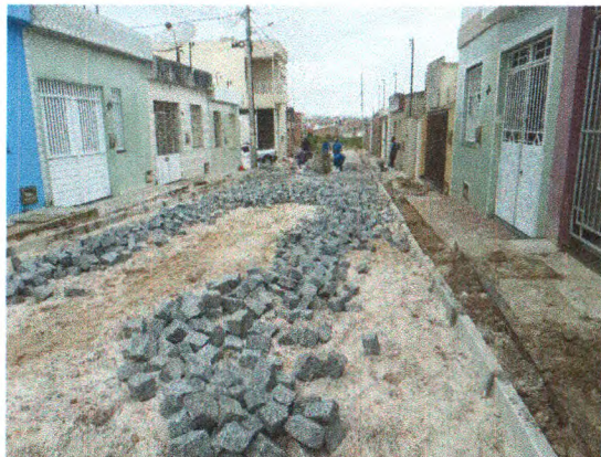
COLCHÃO DE AREIA, MEIO FIO E PARALELEPIPEDO NA TRV. XISTO ALVES DOS SANTOS
