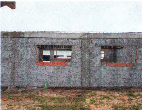
ALVENARIA DE BLOCO CERÂMICO; PILARES, VERGA E CONTRAVERGA EM CONCRETO ARMADO; CHAPISCO
