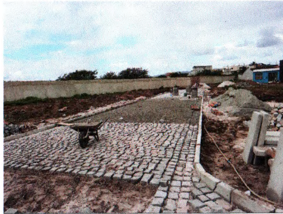
RUA PROJETADA "A" - COLCHÃO DE AREIA; ASSENTAMENTO MEIO-FIO E PARALELEPÍPEDO; DRENAGEM SUPERFICIAL
