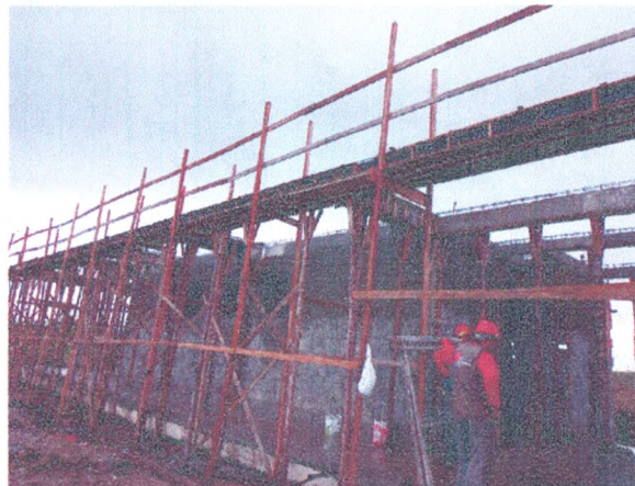
ADMINISTRAÇÃO - FERRAGEM, FORMA E CONCRETO PILARES E VIGAS; ALVENARIA DE BLOCO; CHAPISCO
