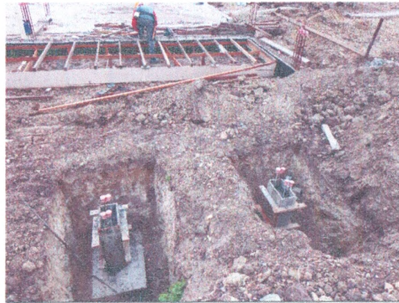
ADMINISTRAÇÃO - ESCAVAÇÃO; CONCRETO MAGRO; FERRAGEM; CONCRETAGEM DA SAPATA; FORMA DA LAJE EM BALANÇO
