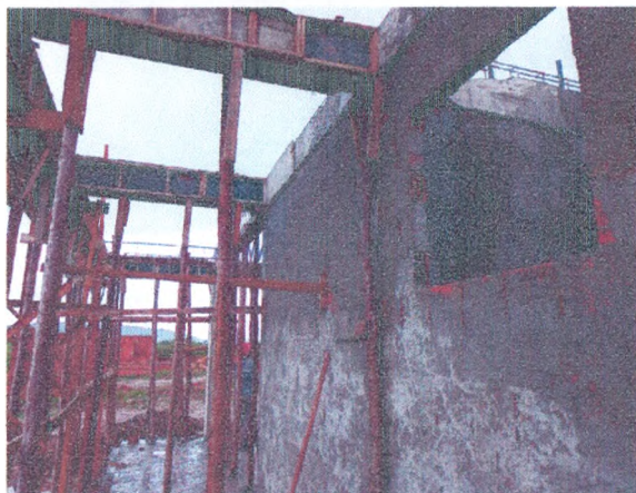
ADMINISTRAÇÃO - FERRAGEM, FORMA E CONCRETO PILARES E VIGAS; ALVENARIA DE BLOCO; CHAPISCO
