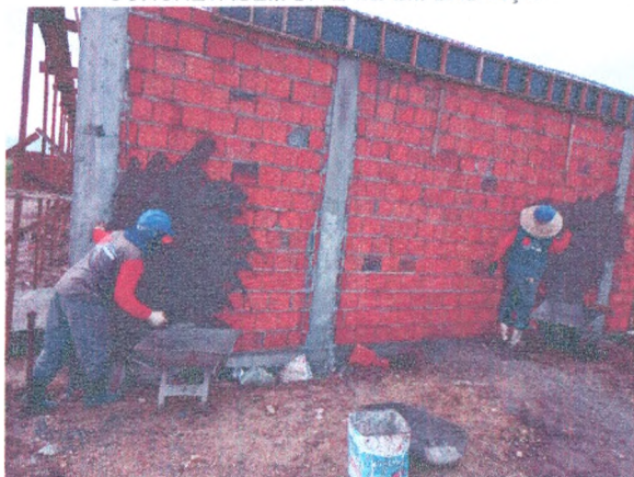
ADMINISTRAÇÃO - FERRAGEM, FORMA E CONCRETO PILARES E CINTAMENTO SUPERIOR; ALVENARIA DE BLOCO; CHAPISCO
