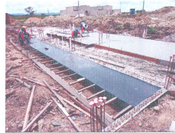
ADMINISTRAÇÃO - ESCAVAÇÃO; CAMADA IMPERMEABILIZADORA; FERRAGEM; CONCRETAGEM DA SAPATA; FORMA DA LAJE EM BALANÇO
