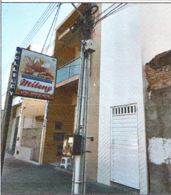
Medição e quadro de comando nº 1 da Av. Manoel Francisco Teles
