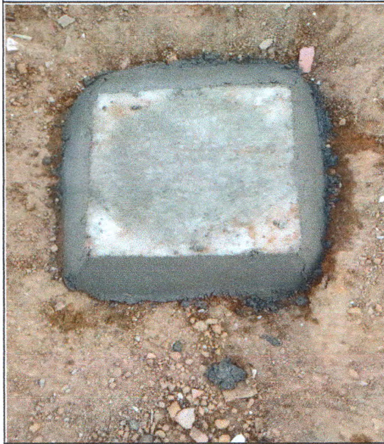
Caixa de passagem lacrada da Av. Engenheiro Carlos Reis
