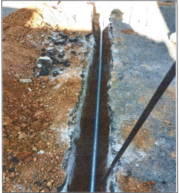
Tubulação de fe galv.cruzamento da pista medição nº 1 da Av. Manoel Francisco Teles
