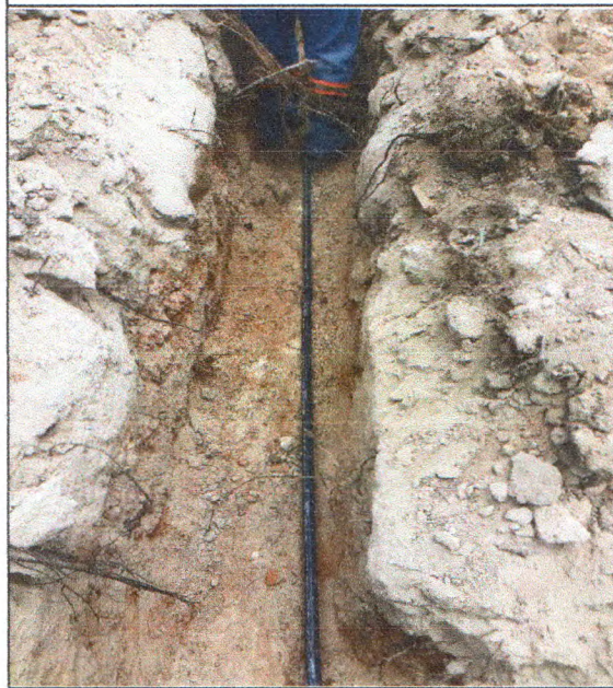
Tubulação de PVC da Av. Engenheiro Carlos Reis
