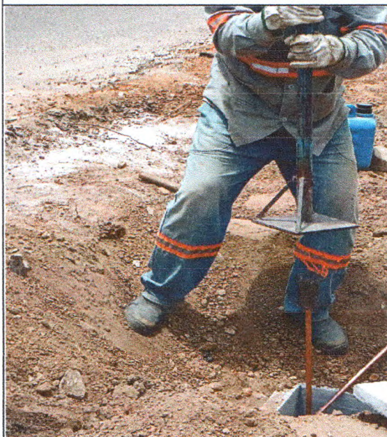
Haste de aterramento na caixa de passagem de alvenaria na Av. Engenheiro Carlos Reis
