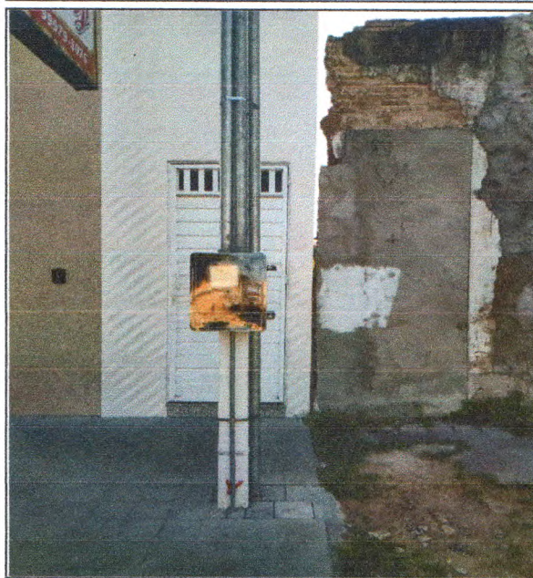
Caixa de medição nº 1 da Av. Manoel Francisco Teles
