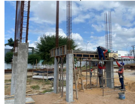
FORMA DAS VIGAS, CORTE E DOBRA DE AÇO PARA AS VIGAS, CONCRETAGEM DOS PILARES E VIGAS
