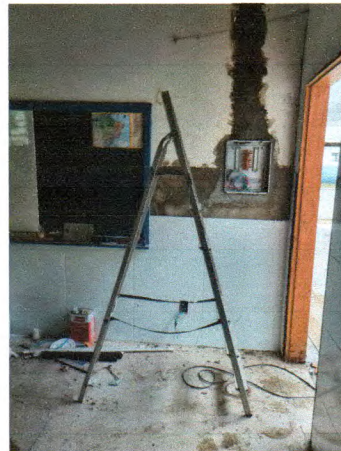
Fotos 09. Novo quadro de energia do bloco sala de aula
