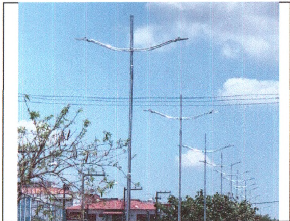
POSTES E LUMINÁRIAS
