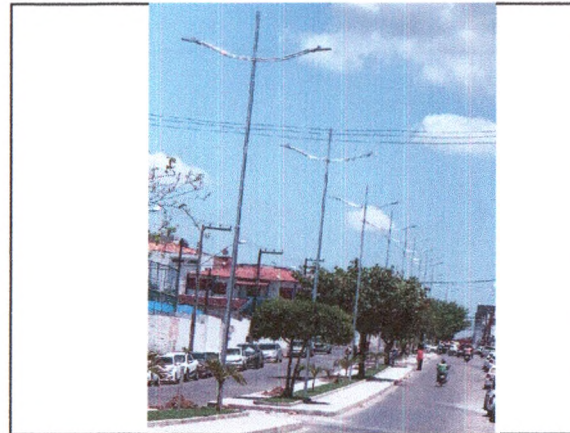
POSTES E LUMINÁRIAS
