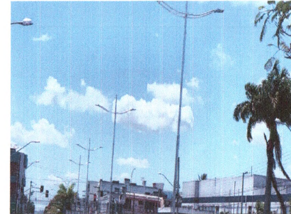
POSTES E LUMINÁRIAS
