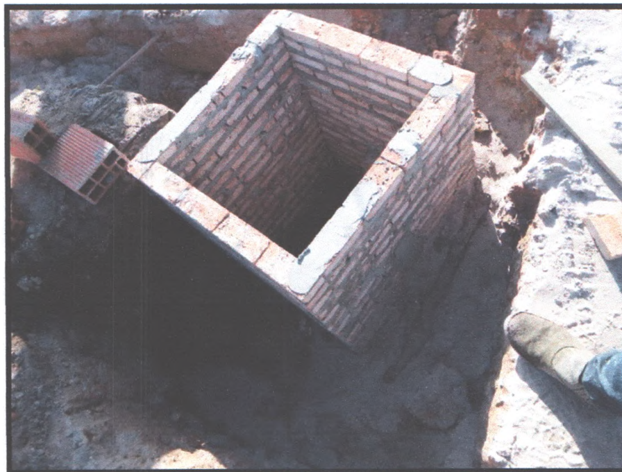
Figura 35: Caixas de inspeção e drenagem
