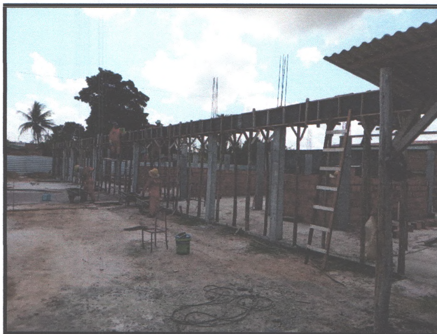
Figura 37: Execução de alvenaria de vedação e montagem de forma para concretagem de viga
