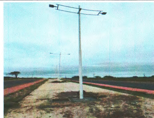
INSTALAÇÕES ELETRICAS DA AVENIDA JOÃO DE DEUS SOUSA
