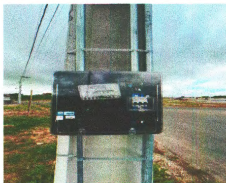
INSTALAÇÕES ELETRICAS DA AVENIDA JOÃO DE DEUS SOUSA
