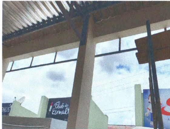
Telha metálica; Estrutura treliçada da cobertura; Terças metálicas; Pintura sobre superfícies metálicas; Estrutura em concreto armado; Pintura com emassamento acrílico
