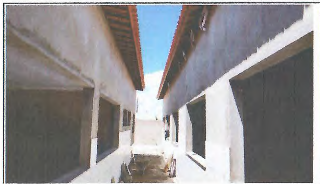
TELHADO, REBOCO E PEITORIL E TUBULAÇÃO DE AR
