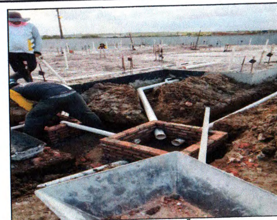
CAIXA DE INSPEÇÃO
