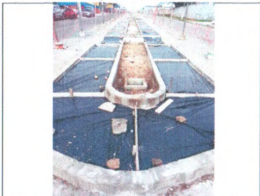
TAPUME DE PROTEÇÃO EM TELA; MEIO-FIO EM CONCRETO; ATERRO COMPACTADO; LONA PLÁSTICA
