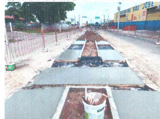
TAPUME DE PROTEÇÃO EM TELA; MEIO-FIO EM CONCRETO; ATERRO COMPACTADO; LONA PLÁSTICA; PISO EM CONCRETO DESEMPOLADO
