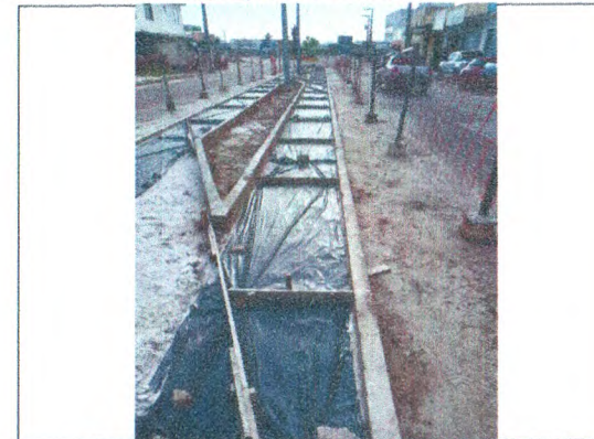
TAPUME DE PROTEÇÃO EM TELA; MEIO-FIO EM CONCRETO; ATERRO COMPACTADO; LONA PLÁSTICA
