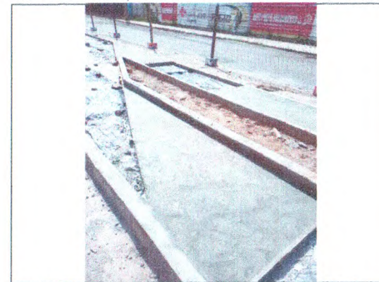
TAPUME DE PROTEÇÃO EM TELA; MEIO-FIO EM CONCRETO; ATERRO COMPACTADO; LONA PLÁSTICA; PISO EM CONCRETO DESEMPOLADO
