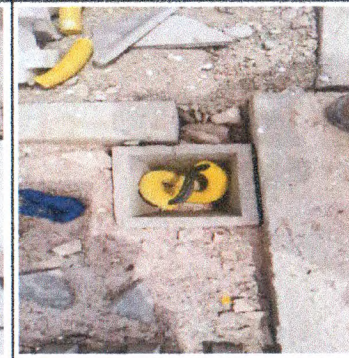
ATERRAMENTO E CAIXAS DE EQUALIZAÇÃO
