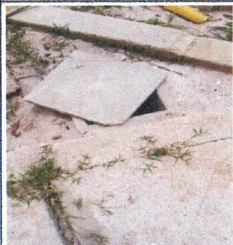
ATERRAMENTO E CAIXAS DE EQUALIZAÇÃO
