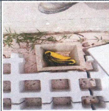
ATERRAMENTO E CAIXAS DE EQUALIZAÇÃO
