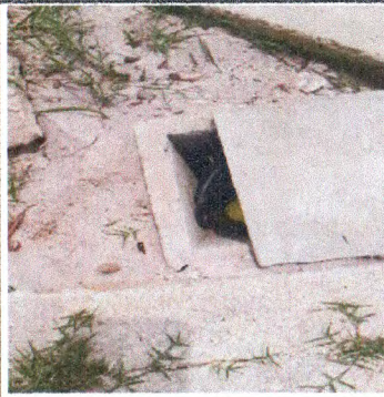
ATERRAMENTO E CAIXAS DE EQUALIZAÇÃO
