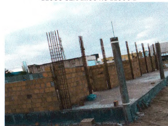
IMPERMEABILIZAÇÃO DAS VIGAS; ALVENARIA DE BLOCO CERÂMICO; FERRAGEM E CONCRETO DOS PILARES DO BLOCO B
