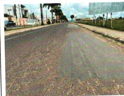
RECUPERAÇÃO PAV. ASFÁTICA (AVENIDA RINALDO MOTA E PROXIMIDADES)
