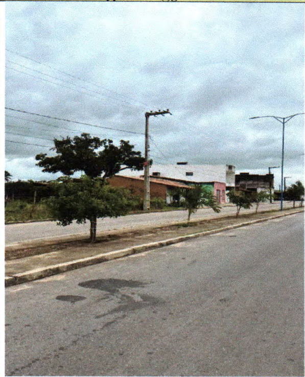
Figura 17: Fornecimento e espalhamento de terra vegetal, plantio de gramas, palmeiras, Ipês e arbustos como também limpeza final da avenida do Riacho Doce
