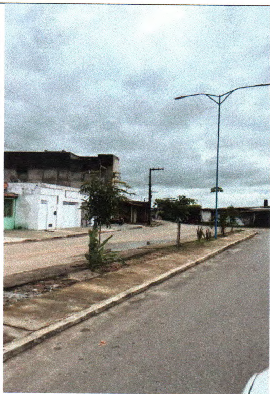
Figura 14: Fornecimento e espalhamento de terra vegetal, plantio de gramas, palmeiras, Ipês e arbustos como também limpeza final da avenida do Riacho Doce
