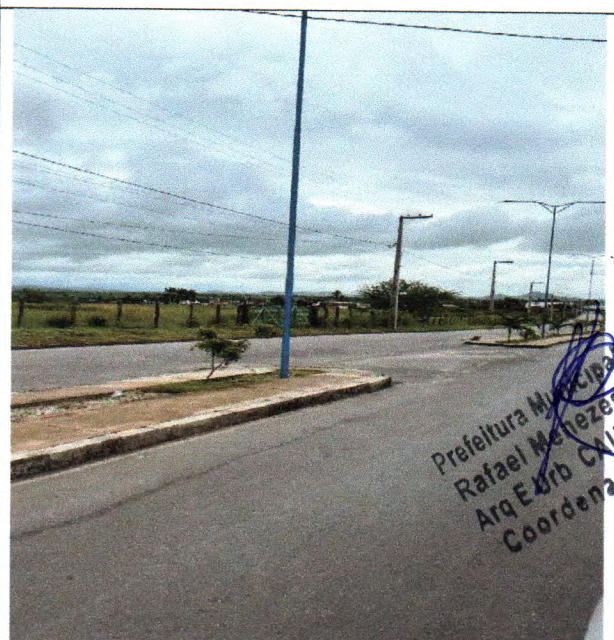
Figura 04: Fornecimento e espalhamento de terra vegetal, plantio de gramas, palmeiras, Ipês e arbustos como também limpeza final da avenida do Riacho Doce
