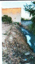
CANAL DA AVENIDA MANOEL FRANCISCO TELES
