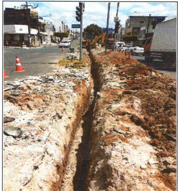
Tubulação de PVC
