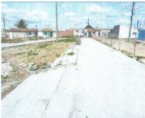
ASSENTAMENTO DE MEIO FIO, PISO EM CONCRETO
