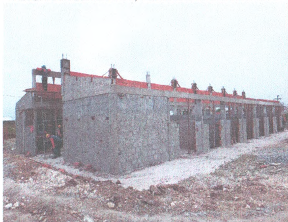
BAIAS COBERTAS - ATERRO COMPACTADO; ALVENARIA DE BLOCOS; FERRAGENS E CONCRETO DOS PILARES; CHAPISCO
