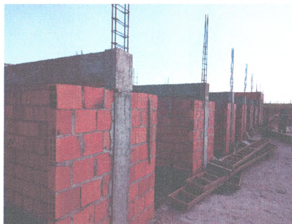
BAIAS COBERTAS - ATERRO COMPACTADO; ALVENARIA DE BLOCOS; FERRAGENS E CONCRETO DOS PILARES
