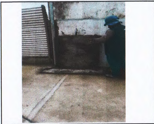
MURETA PADRÃO DE ENTRADA.
