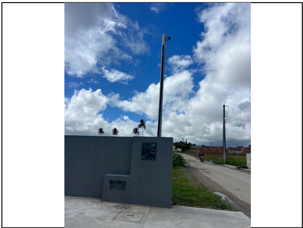
PADRÃO DE ENTRADA DE ENERGIA - POSTE GALVANIZADO; CAIXA DE MEDIÇÃO
