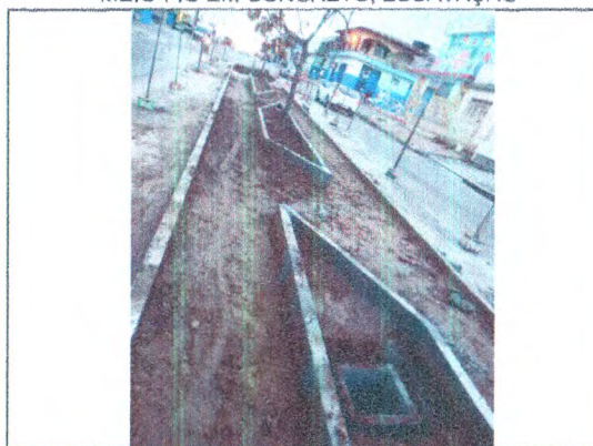
TAPUME DE PROTEÇÃO EM TELA; ESCAVAÇÃO; MEIO-FIO EM CONCRETO; CAIXA DE PASSAGEM
