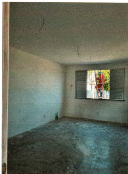
Fotos 21. Pintura de paredes (1 demão), instalação de esquadrias e novos circuitos elétricos
