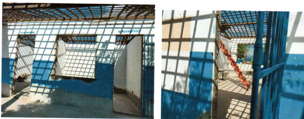
Fotos 06. Remoção de esquadrias de madeira, gradis e telhas para lavagem e substituição do madeiramento
