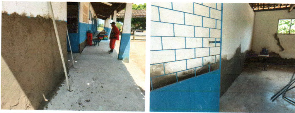
Fotos 05. Demolição de reboco e execução de novo chapisco e reboco do Bloco da Administração
