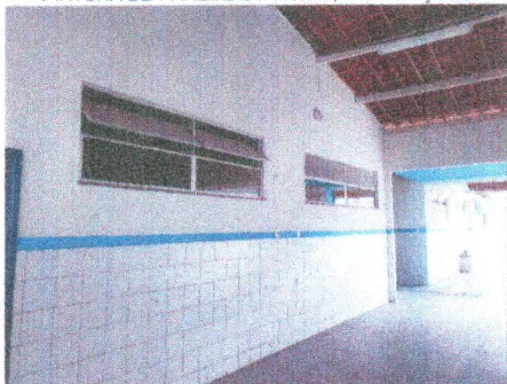
PINTURA DE PAREDES; REVISÃO DE ESQUADRIAS DE ALUMÍNIO; VIDROS; INSTALAÇÕES ELÉTRICAS; POLIMENTO DO PISO EM ALTA RESISTÊNCIA
