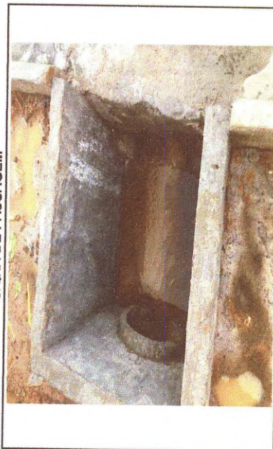
CAIXA DE PASSAGEM
