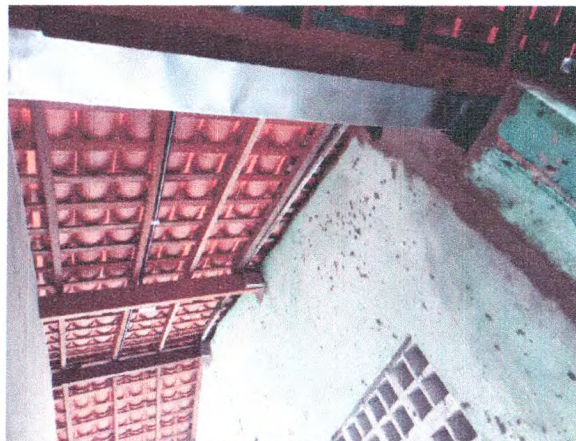
CALHA EM CHAPA DE AÇO GALVANIZADO
