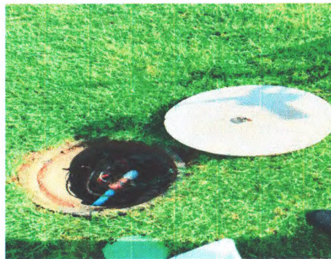
CASA DE BOMBAS DA AVENIDA JOAO DE DEUS SOUSA
