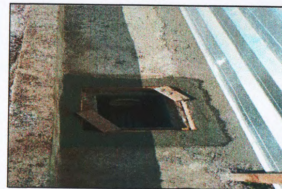
CAIXA DE PASSAGEM
