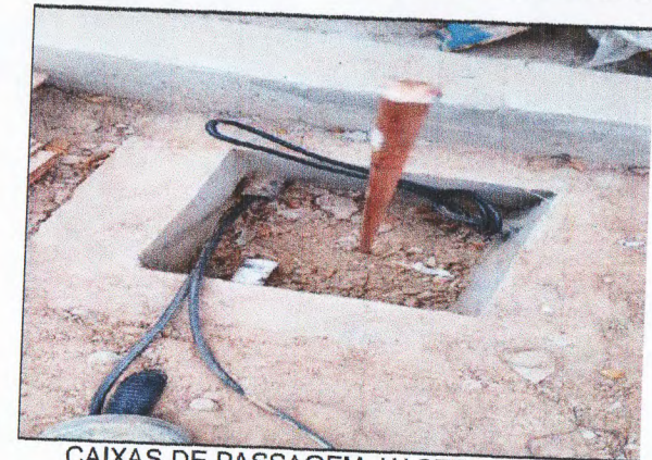
CAIXAS DE PASSAGEM, HASTE E CABOS
