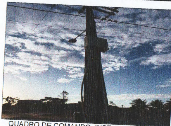
QUADRO DE COMANDO, INST. DA INTERNET
