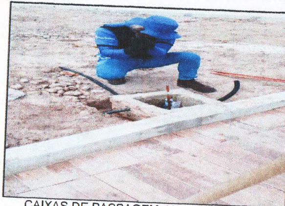
CAIXAS DE PASSAGEM, HASTE E CABOS
