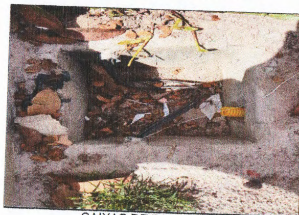
CAIXAS DE PASSAGEM
