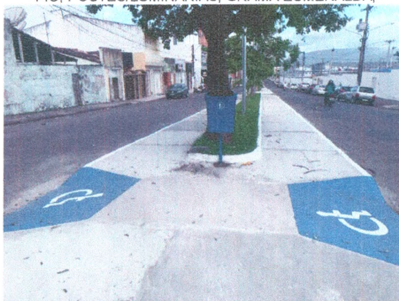
PISO EM CONCRETO DESEMPOLADO; PINTURA DE RAMPAS PARA ACESSO DE DEFICIENTES; LIXEIRA; GRAMA ESMERALDA
