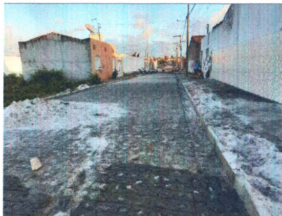
RUA JOSÉ VINCENTE DE ALMEIDA - REGULARIZAÇÃO DO TERRENO; COLCHÃO DE AREIA; MEIO-FIO
