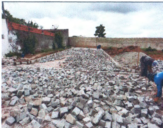
RUA JOSÉ VINCENTE DE ALMEIDA - REGULARIZAÇÃO DO TERRENO; COLCHÃO DE AREIA; MEIO-FIO
