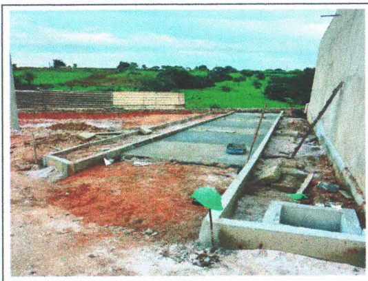
CAIXA DE PASSAGEM
