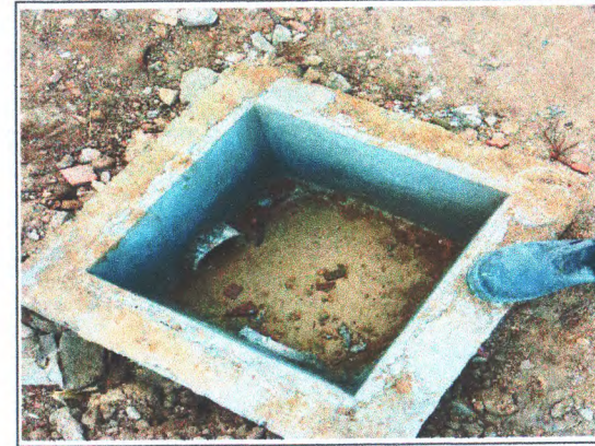
CAIXA DE PASSAGEM
