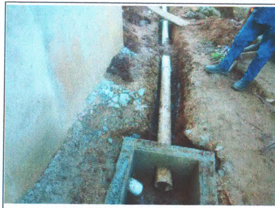
CAIXA DE PASSAGEM
