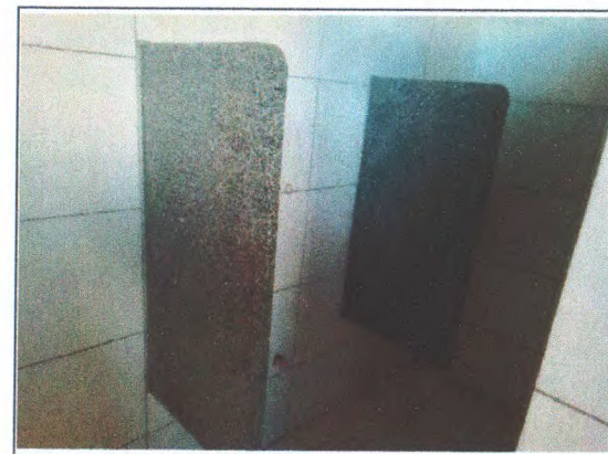
DIVISÓRIA EM GRANITO
