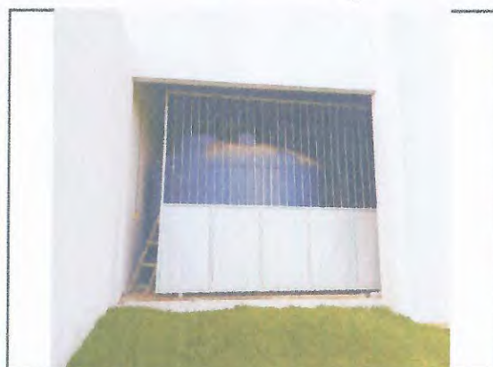
RESERVATÓRIO - PORTÃO DE FERRO E CHAPA; PINTURA DE PAREDE E ESQUADRIA METÁLICA
