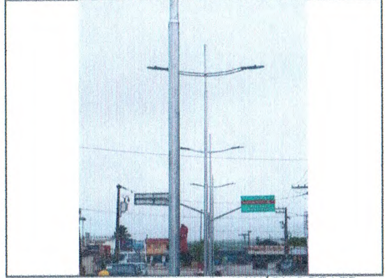
POSTES GALVANIZADOS E LUMINÁRIAS DE LED
