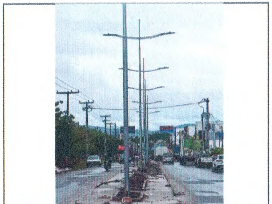
POSTES GALVANIZADOS E LUMINÁRIAS DE LED; MEIO-FIO E PISO EM CONCRETO DESEMPOLADO
