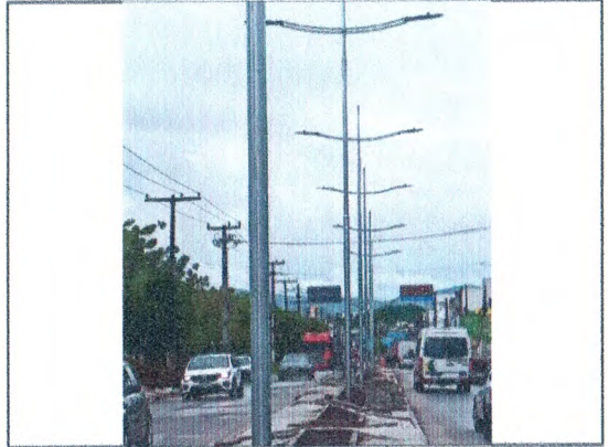
POSTES GALVANIZADOS E LUMINÁRIAS DE LED; MEIO-FIO E PISO EM CONCRETO DESEMPOLADO
