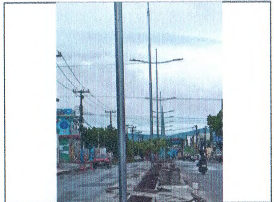
POSTES GALVANIZADOS E LUMINÁRIAS DE LED; MEIO-FIO E PISO EM CONCRETO DESEMPOLADO; TERRA VEGETAL
