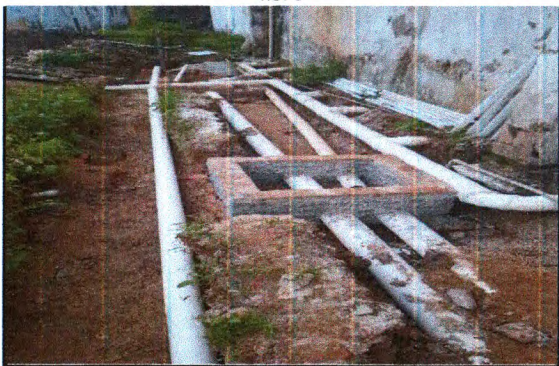
CAIXA DE PASSAGEM
