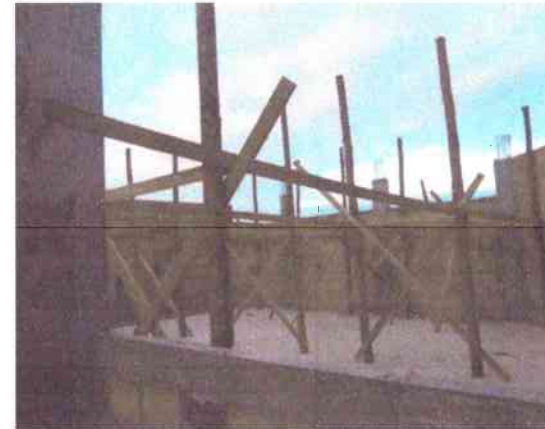
EXECUÇÃO DA ALVENARIA DE BLOCO CERÂMICO NO BLOCO C; VERGAS E CONTRAVERGAS;
