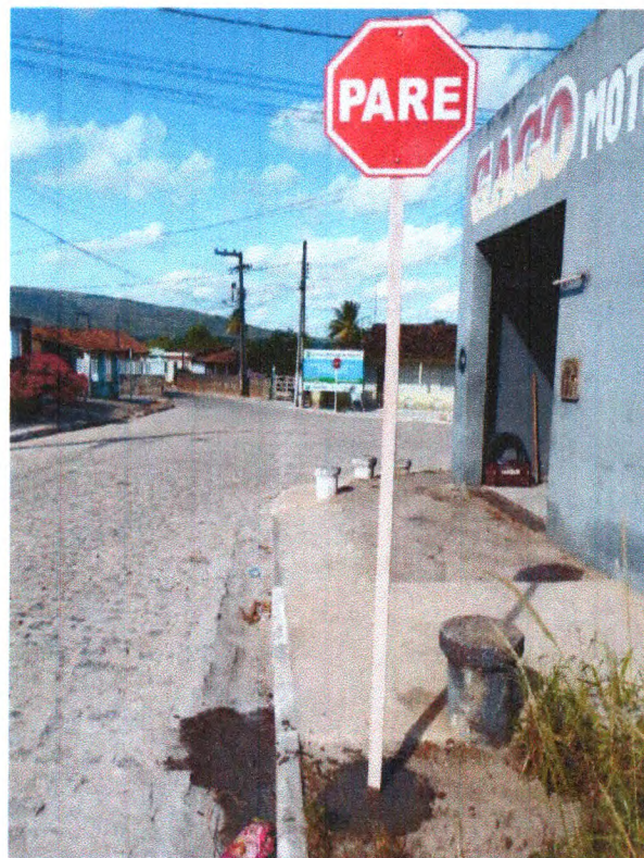
Foto 08 – Placa de Sinalização – Trecho 01
