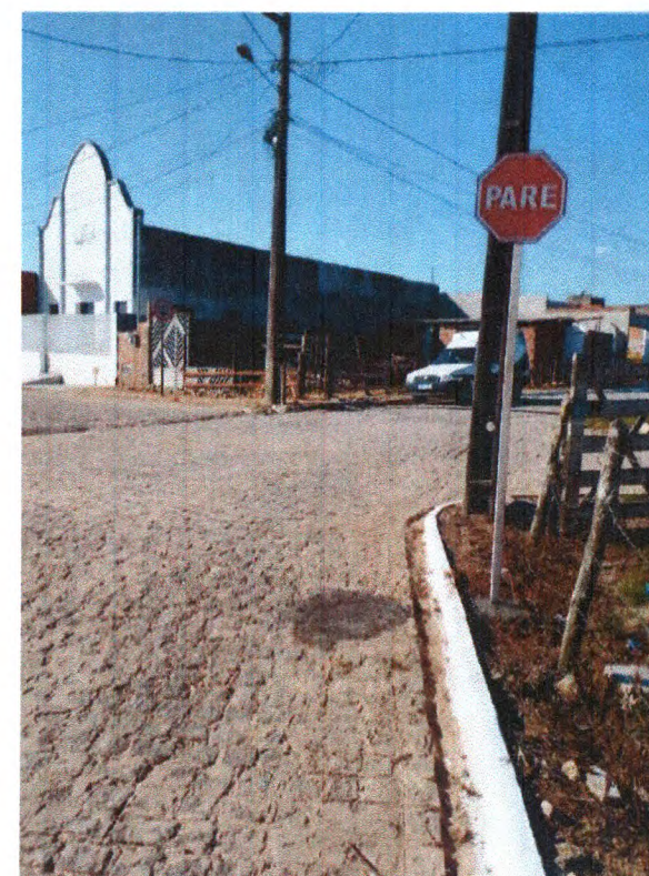
Foto 10 – Placa de Sinalização – Trecho 03
