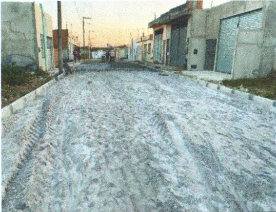
COLCHÃO DE AREIA, MEIO FIO E PARALELEPIPEDO NA RUA JOSÉ ARAÚJO FERREIRA JUNIOR
