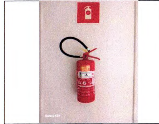
EXTINTOR DE INCÊNDIO
