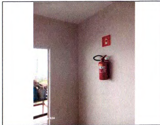
EXTINTOR DE INCÊNDIO
