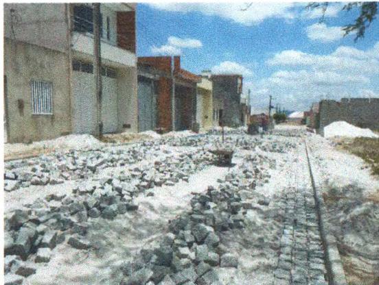
COLCHÃO DE AREIA, MEIO FIO E PARALELEPIPEDO NA RUA JOSÉ ARAÚJO FERREIRA JUNIOR
