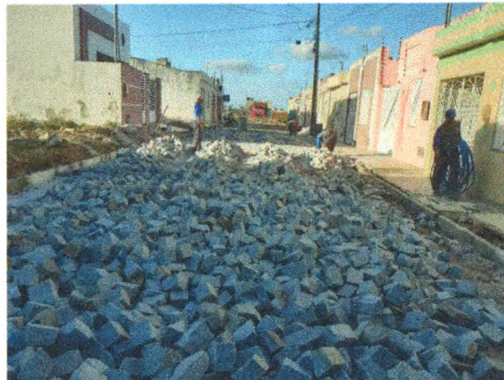
COLCHÃO DE AREIA, MEIO FIO E PARALELEPIPEDO NA RUA MARIA LUIZA MENDONÇA
