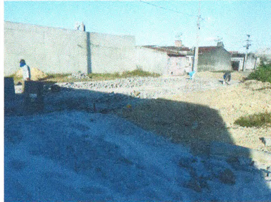
COLCHÃO DE AREIA, MEIO FIO E PARALELEPIPEDO NA RUA TERCILIO PASSOS OLIVEIRA
