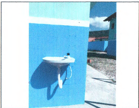
LAVATÓRIO DE LOUÇA; PONTOS DE ÁGUA E ESGOTO
