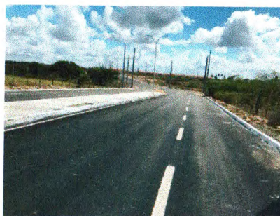
MEIO-FIO - AV. IRMÃ MARIA AUXILIADORA
