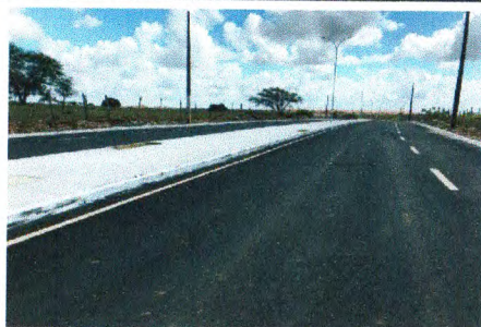
MEIO-FIO - AV. IRMÃ MARIA AUXILIADORA
