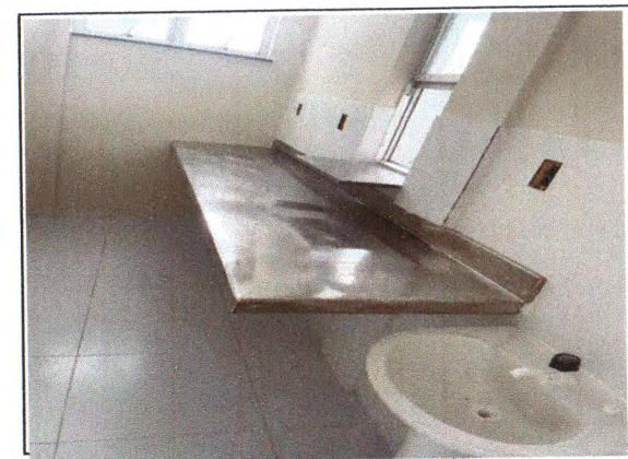
Bancada de aço inox
