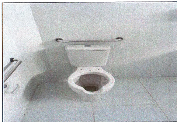
Vaso sanitário e barras de apoio 01
