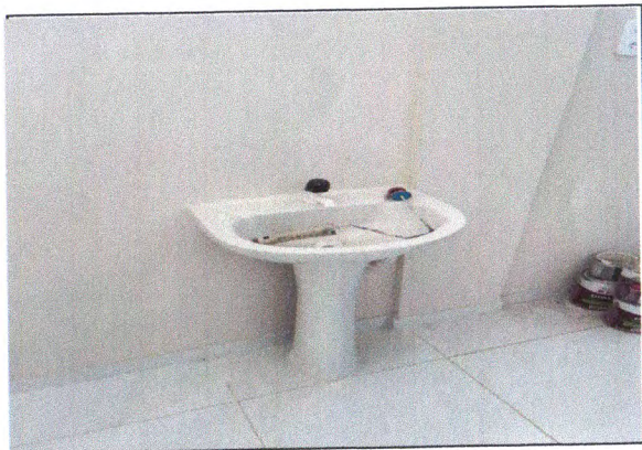
Lavatório de louça
