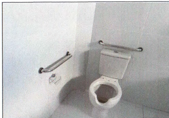
Vaso sanitário e barras de apoio 02
