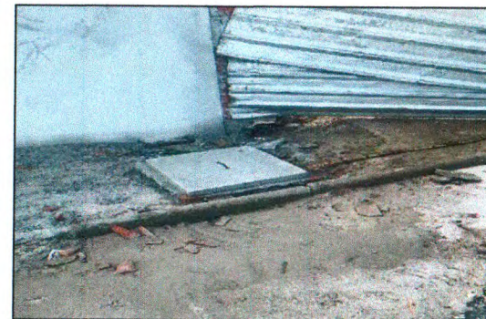
CAIXA DE PASSAGEM
