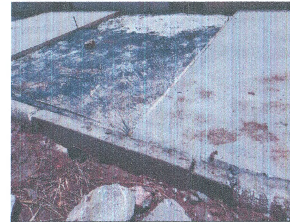
ASSENTAMENTO DE MEIO-FIO; LONA PLÁSTICA; PISO EM CONCRETO DESEMPOLADO
