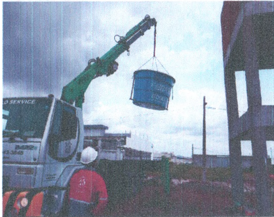
RESERVATÓRIO ELEVADO - CAIXA D'ÁGUA EM FIBRA DE VIDRO 5.000L
